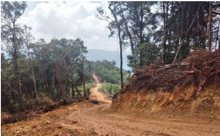
Gambar 26. Jalan di dalam kawasan hutan Suaka Margasatwa Barumun Sumatra Utara
